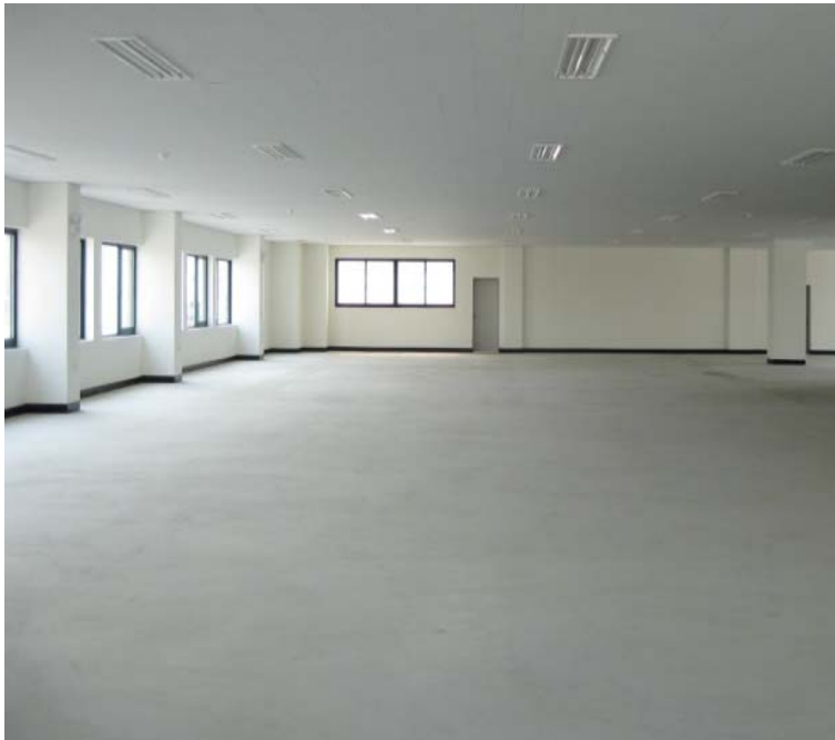
5階賃貸事務室(大) 内部全景
